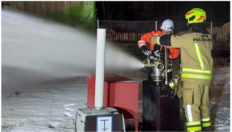
Tehdaspalokunta tarkistaa palopostiä säännöllisesti.
